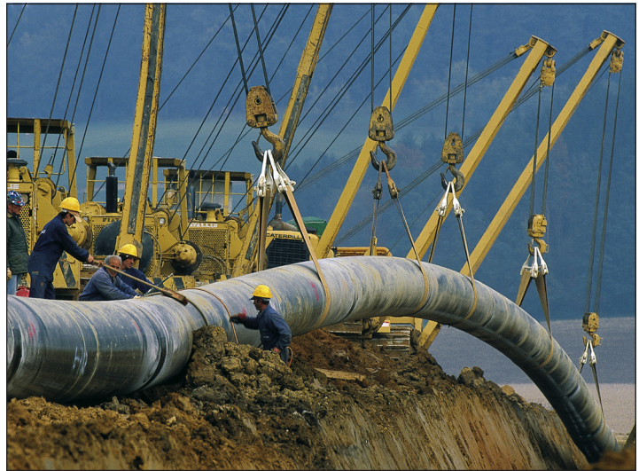
Die Infrastruktur wird laufend ausgebaut, um die Versorgungssicherheit mit Erdgas in Österreich weiter zu steigern.
